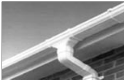
Figura 4.13. Canaletas de recolección
